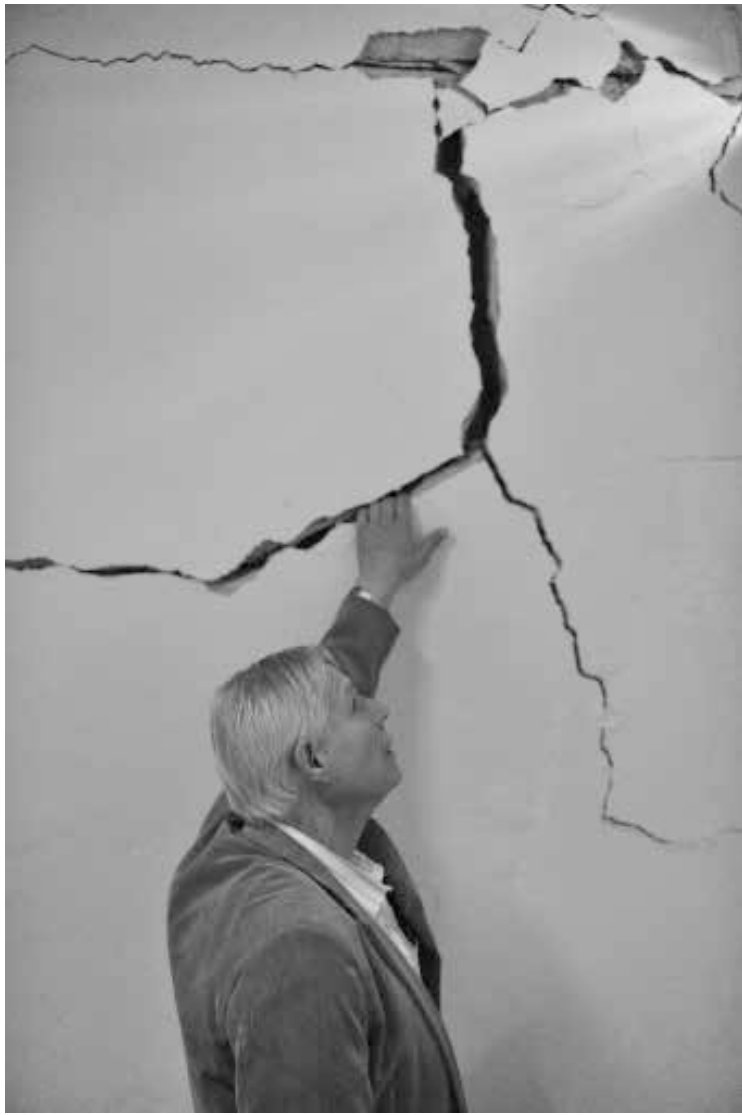
Grietas en una casa de Silwan. Imagen: cortesía de Gagi Dagon.
